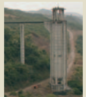
La diga di Bumbuna finanziata dalla Cooperazione italiana darà energia elettrica a tutta la zona
